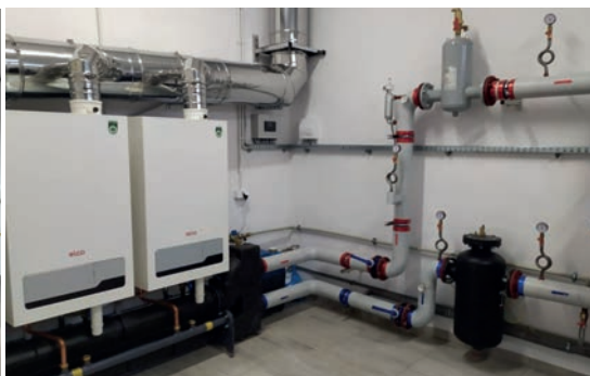
▲ Nowoczesna kotłownia gazowa w ZS w Krzepicach
